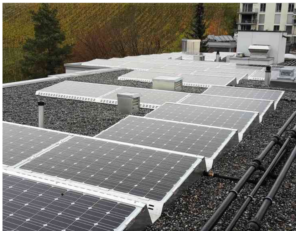
160 m 2 Hybridkollektoranlage auf dem Mehrfamilienhaus-Flachdach.
